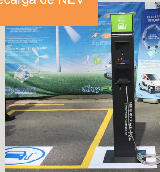
Posto de Recarga de NEV
